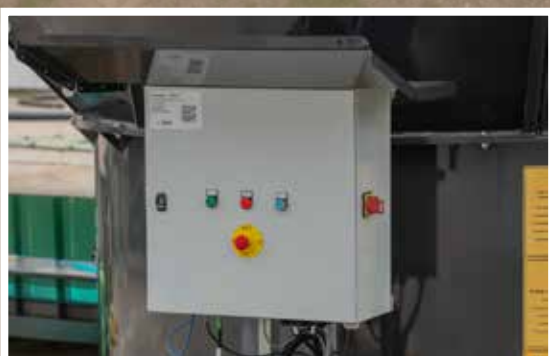
Schaltschrank mit Regenschutz
