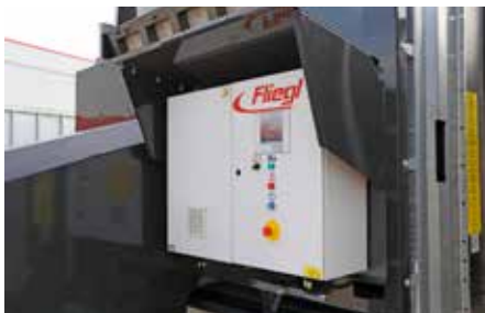
Armoire de commande
